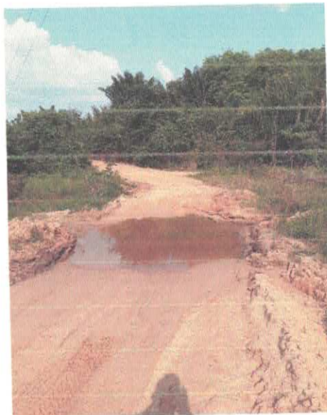
Imagem 04: Na altura do km 22,60. Passagem molhada, necessitando de bueiro duplo de 100.
