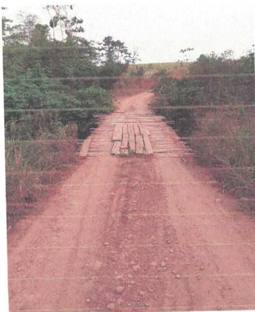
Imagem 03: Na altura do km 16,10. Ponte em madeira de lei 14m. Necessitando de recuperação com troca de assoalho, deslizantes, guarda roda e guarda corpo.
