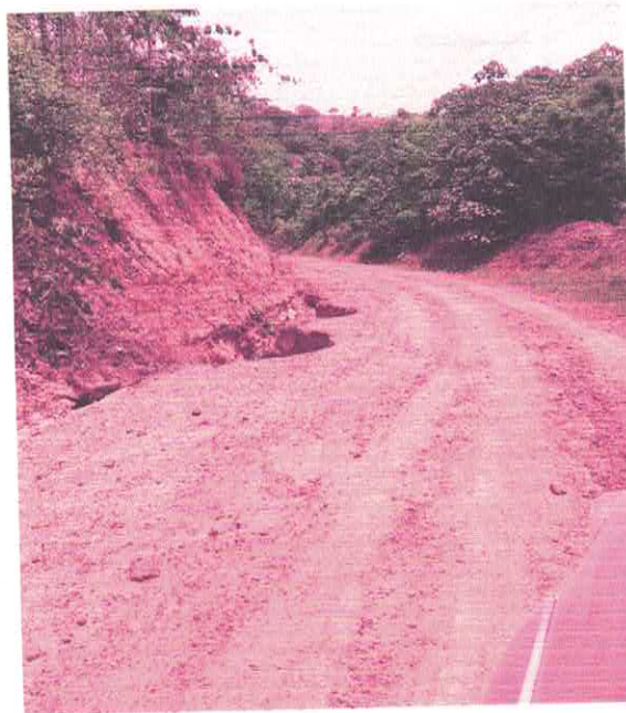
Imagem 03: Na altura do km 7,70. Lateral da pista com grande formação de erosão na ladeira de aclividade bem acentuada e sem revestimento laterítico na estrada.
