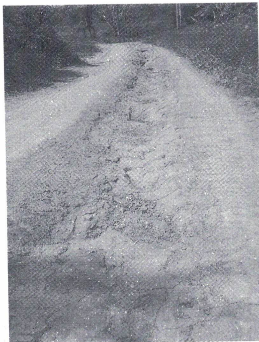
Imagem 15: Trecho crítico com erosões devido ao forte inverno que passou na altura do km 14,40.
