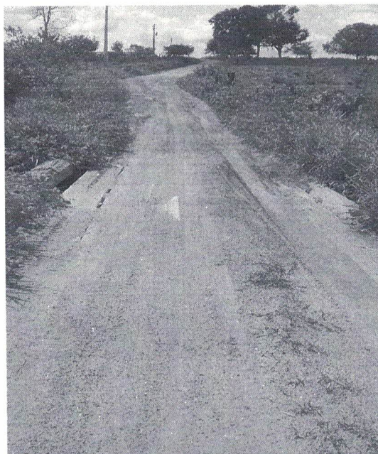
Imagem 08: Pinguela em toras de madeiras na altura do km 10,00. Substituir por BSTC = Ø100.
