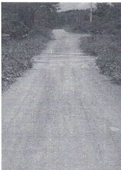
Imagem 05: Pequena Ponte em madeira, substituir por BSTC Ø100 na altura do km 7,30.
