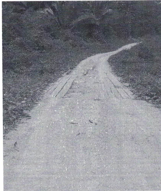
Imagem 10: Ponte em madeira 11 metros na altura do km 11,40, reformar urgente.
