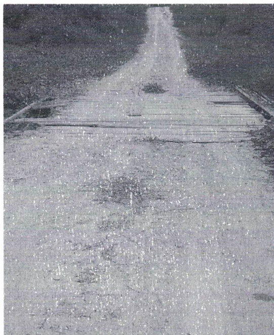
Imagem 12: Pequena Ponte em madeira 6 metros na altura do km 12,40, substituir por BDTC = Ø100.
