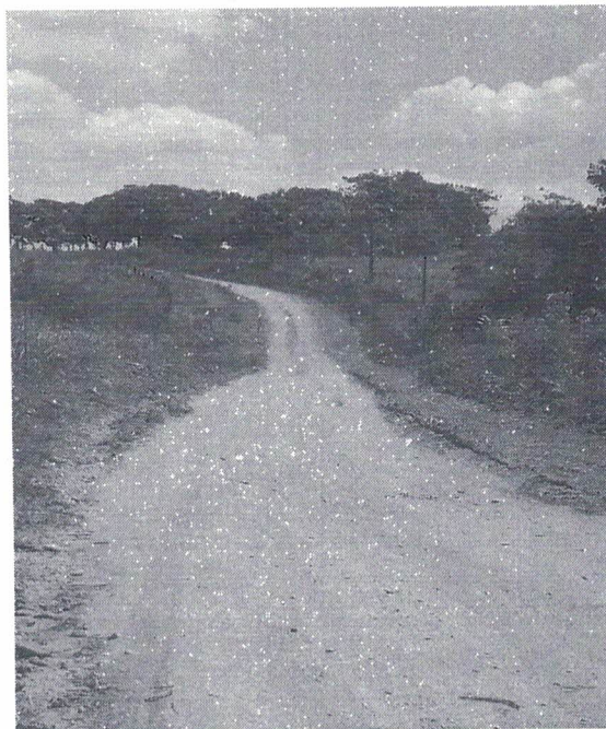
Imagem 13: Ponto de atoleiro no período chuvoso, elevar o aterro na altura do km 25,4
