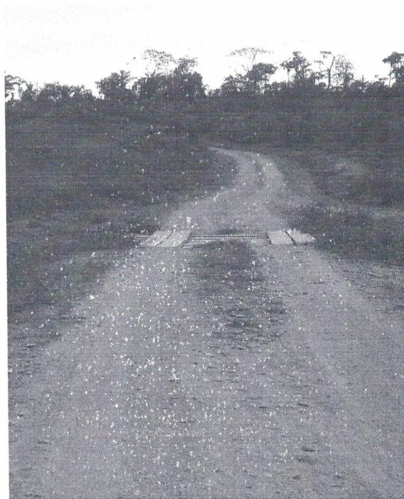
Imagem 15: Pequena Ponte na altura do km 27.6, substituir por BSTC Ø80.
