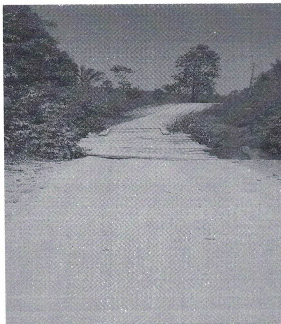
Imagem 08: Ponte em madeira na altura do km 21,2, reconstruir.
