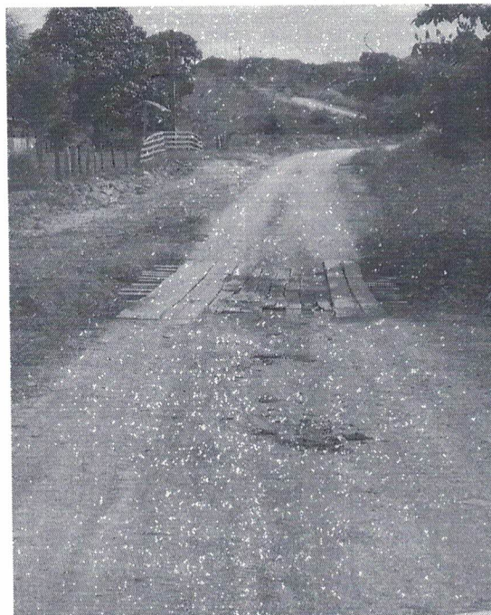
Imagem 23: Pequena ponte na altura do km 38,2. Substituir por BSTC Ø100.
