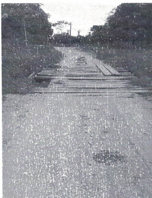
Imagem 17: Ponte em estado crítico na altura do km 33.7, substituir por BDTC Ø100.
