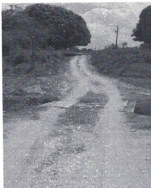
Imagem 24: Pequena ponte em madeira na altura do km 40,3. Substituir por BSTC Ø80.
