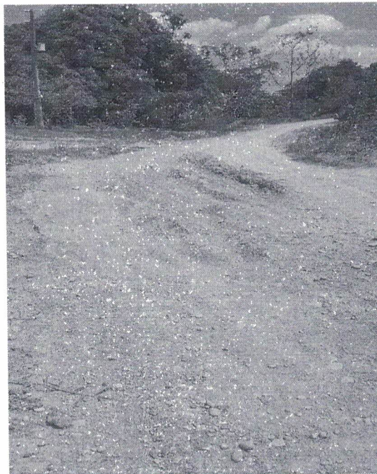
Imagem 19: Trecho crítico no período chuvoso tornando sempre um imenso atoleiro na altura do km 35,2 necessitando de elevação do greide,
