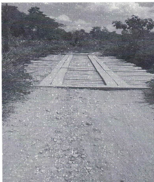
Imagem 20: Ponte em madeira de lei 20 metros na altura do km 35,3. A mesma está em estado crítico necessitando reconstruir urgente.
