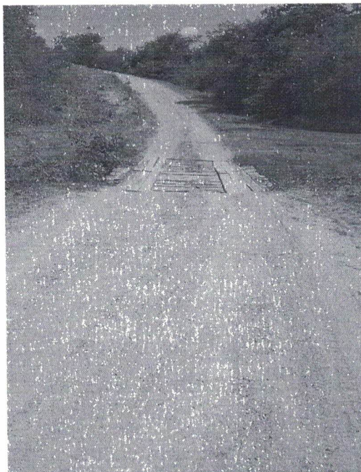
Imagem 07: Ponte em madeira, substituir por BSTC de Ø100 na altura do km 17,8
