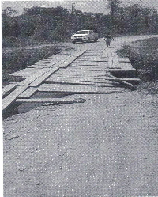
Imagem 14: Ponte em madeira 12 metros na altura do km 26.9, reconstruir.
