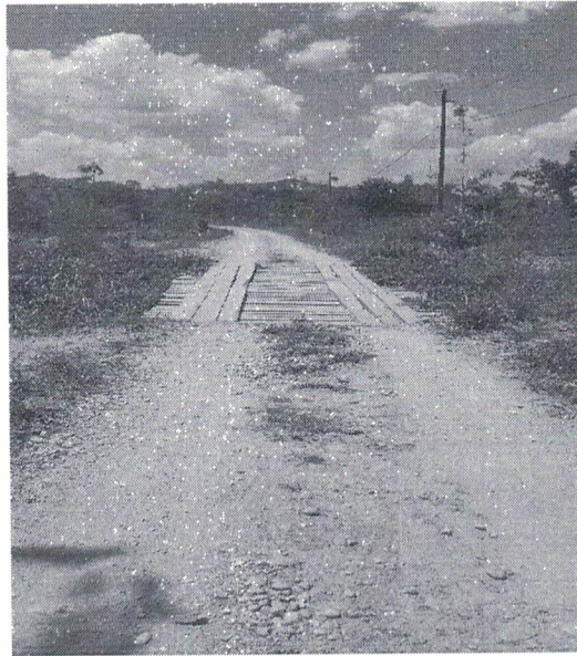
Imagem 18: Ponte em madeira na altura do km 34,5, substituir por BDTC Ø100.
