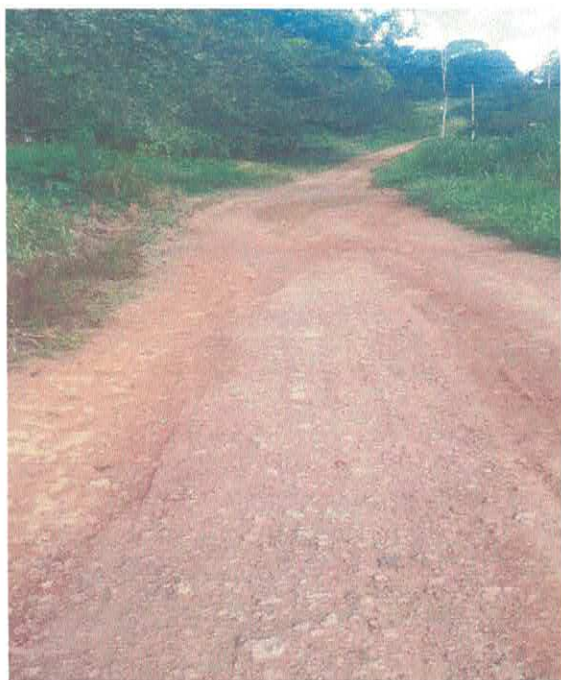
Trecho critico km 3,30 Vic 15
