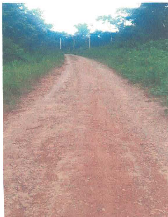
Trecho critico km 1,5 Vic 25
