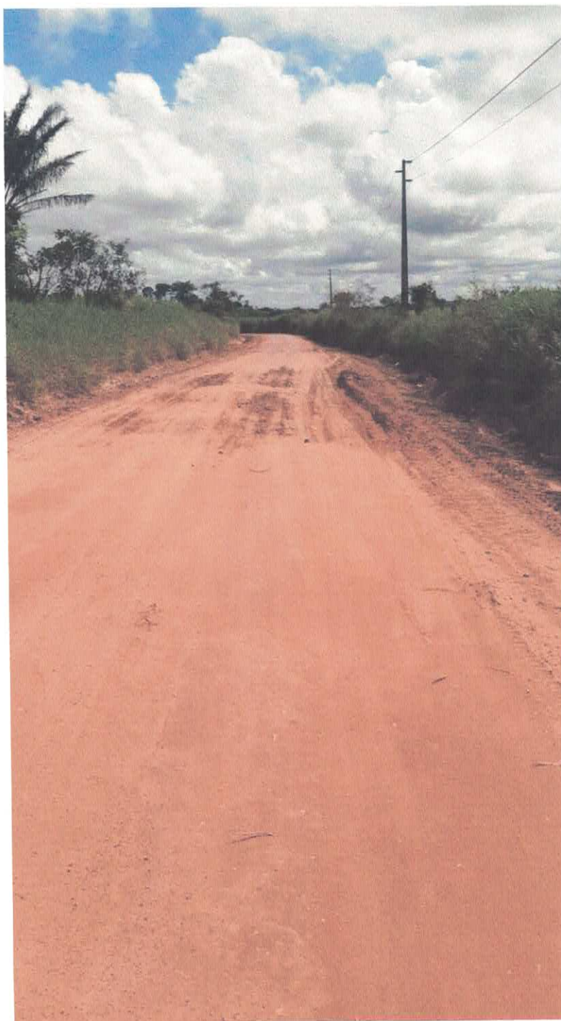
Imagem no km 7,80 - Limpeza lateral e falta de revestimento laterítico.
