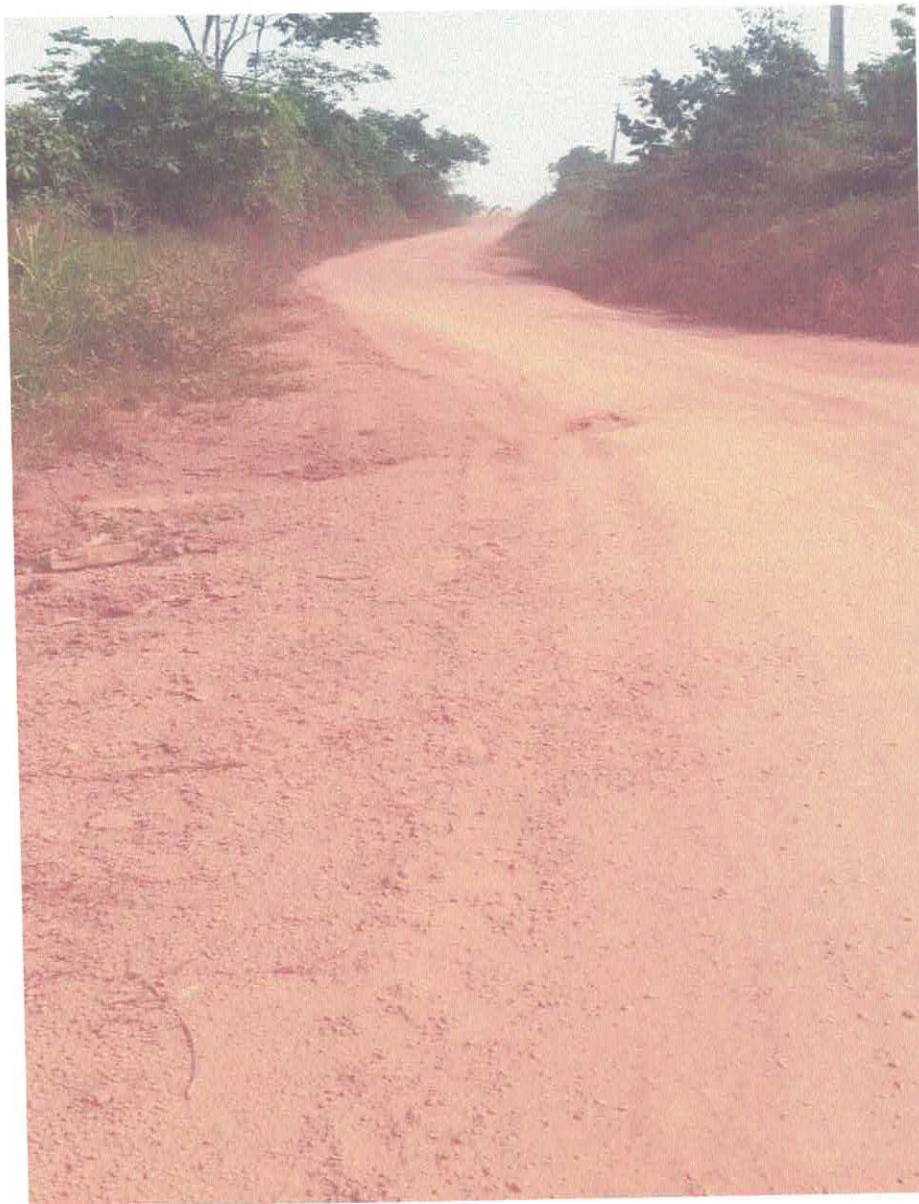
Imagem 04 - Erosão e vegetação avançando a pista no km 4,60
