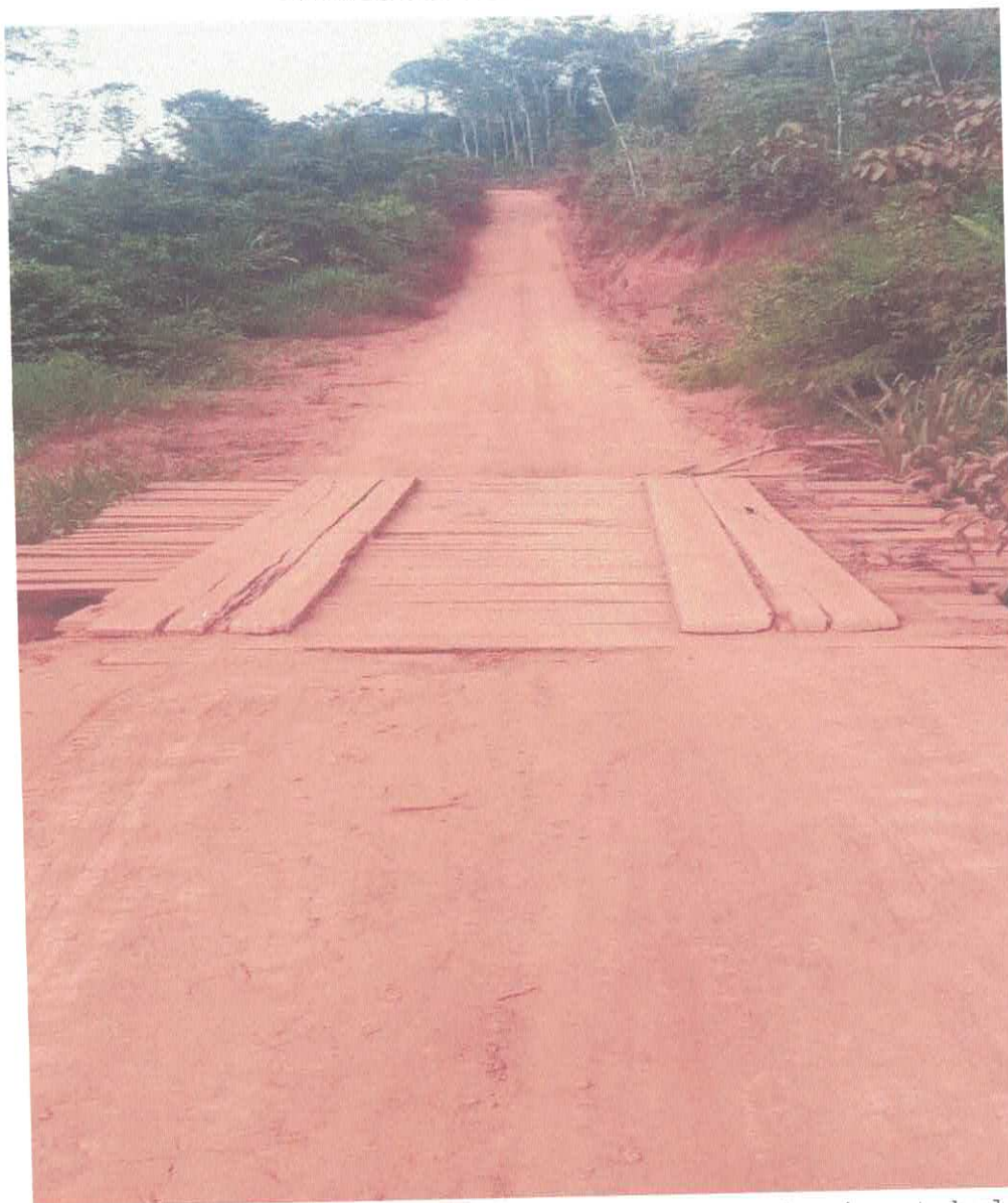
Imagem 08 - Pequena ponte a ser trocada por bueiro tubular na altura do km 17,50.
